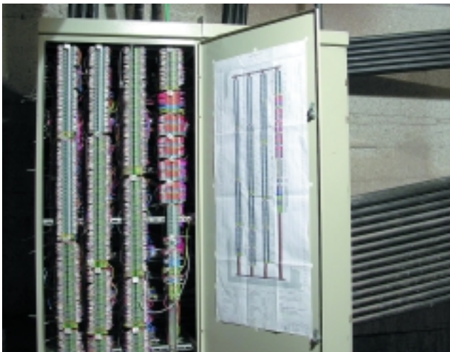
Коммутационный шкаф – один из перекрестков на 250 км новых кабельных линий
